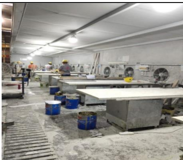
图 3-5 废气处理设施
