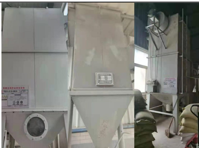
图 3-5 废气处理装置
