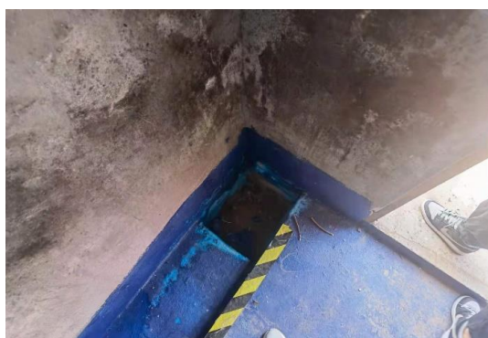
危废仓库四周管沟及收集井
