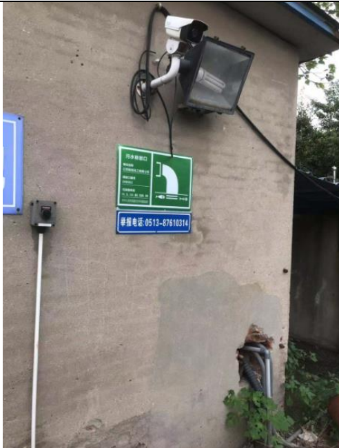
污水排口标志牌
