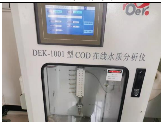
污水排口 COD 在线监测装置
