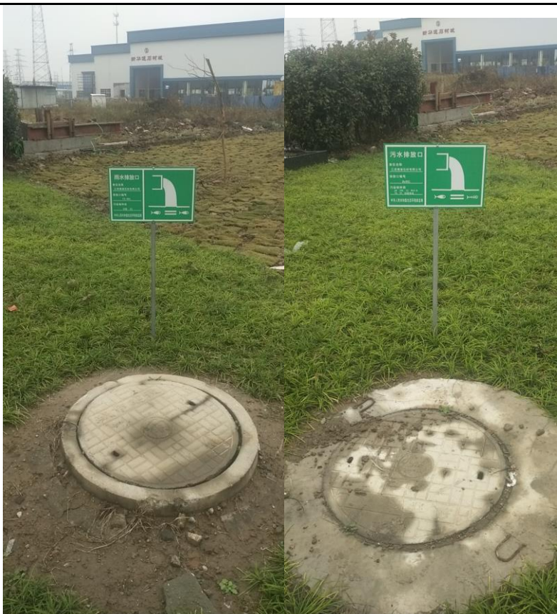
图 3-2 雨水、污水排放口
