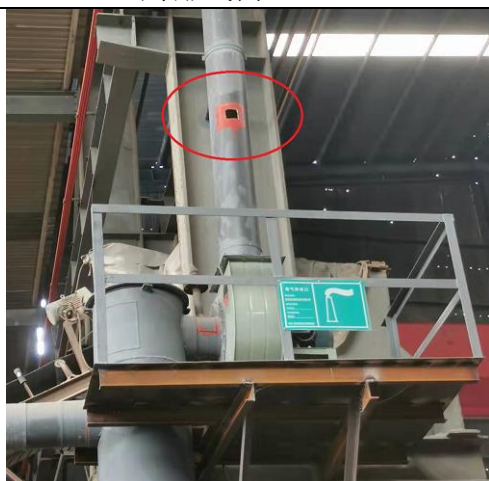
采样平台和采样口
