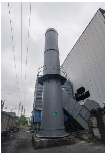
15m 高排气筒（DA001）
