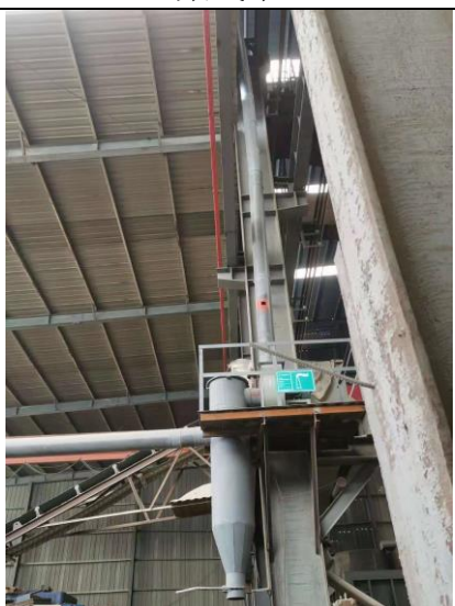
15m 高排气筒（DA002）
