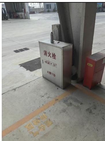
消防栓、灭火器
